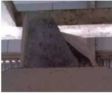
a. Specimen 1 (GFRP bar)
